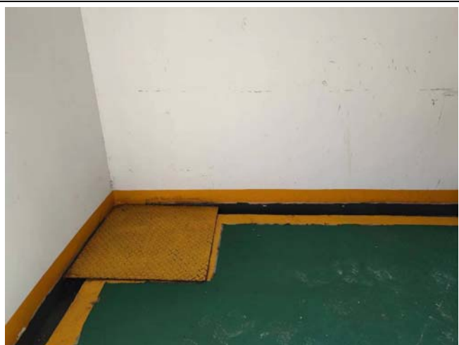
厂区危险废物暂存间收集池
