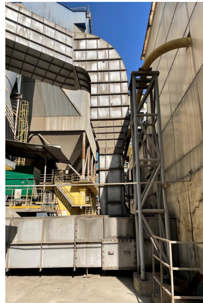
恶臭收集管道
