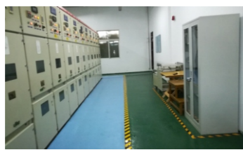
电气室定置化管理 Electrical room localization management
